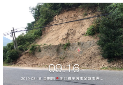
图5 S213省道某上边坡滑塌现场
