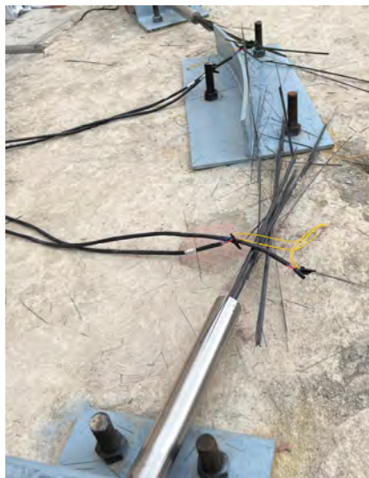
图 6 CFRP 筋破坏状态
