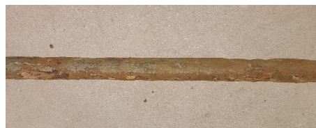
图 16 钢筋均匀锈蚀损伤
