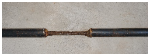
图 11 钢筋点锈蚀损伤
