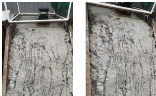
图 13 降雨和动荷载作用下的边坡滑塌
