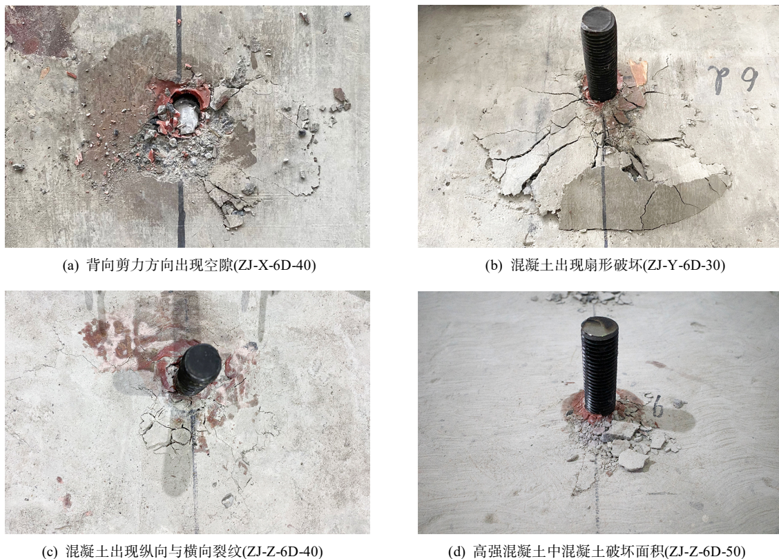
图2 植筋锚栓破坏形态
