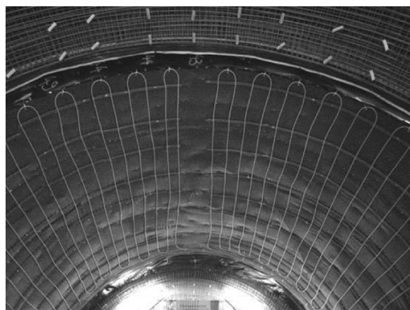
图1 德国 Stuttgart-Fasanenhof 能源隧道 [4]
