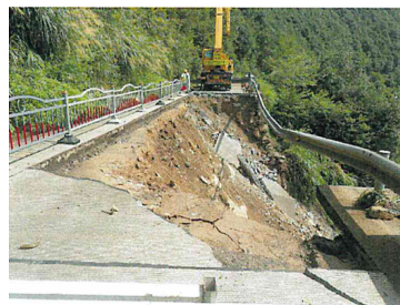
图1 路基边坡滑塌实例
