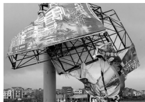
单柱型广告牌破坏
