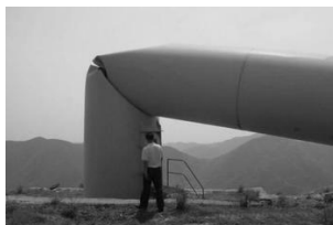
风电结构塔筒弯折
