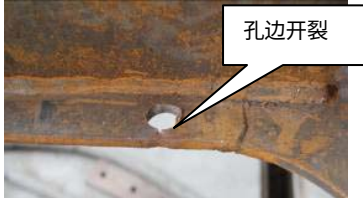
图 10 JD3 试件的破坏照片
